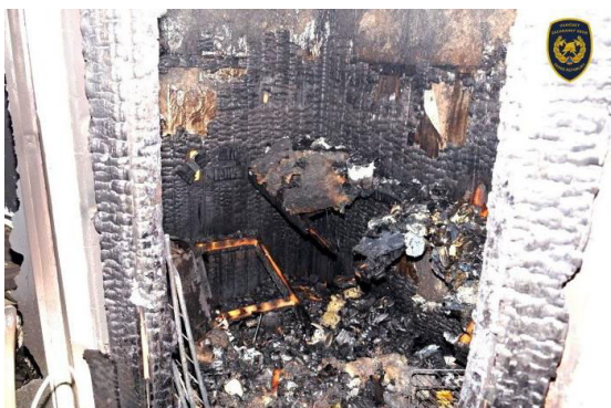
požár způsobený chybnou manipulací s vypínačem
